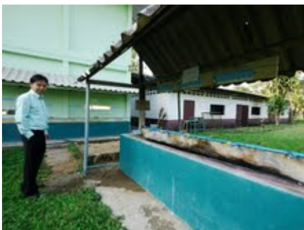
จุดสำหรับติดตั้งถังน้ำใหม่
