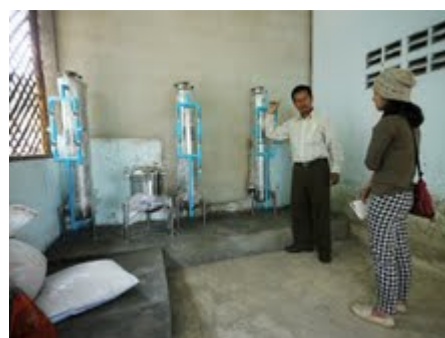
ครูใหญ่แสดงจุดติดตั้งถังน้ำดื่ม ในโรงเรียน
